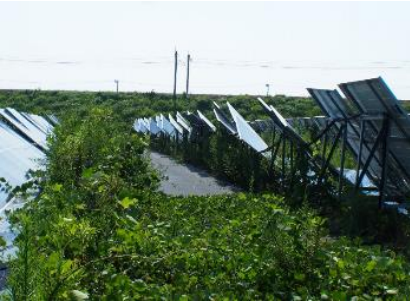
不十分な管理で放置されたパネル
