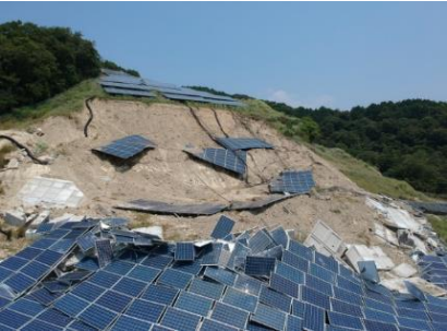
土砂崩れで生じた崩落
